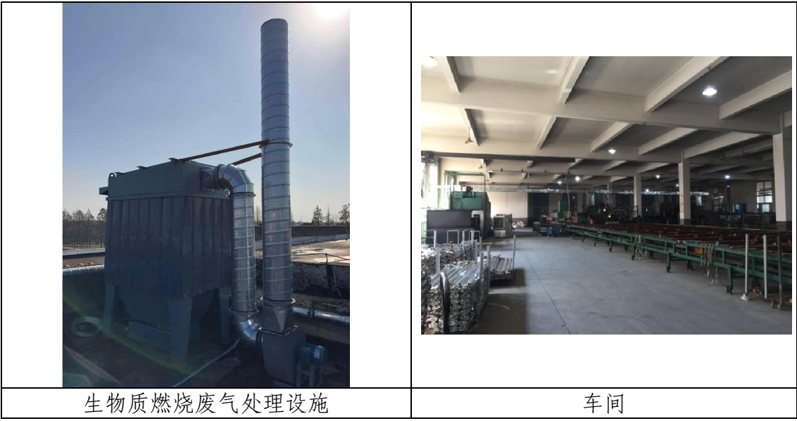
图 4-4 企业废气治理现场相关照片
