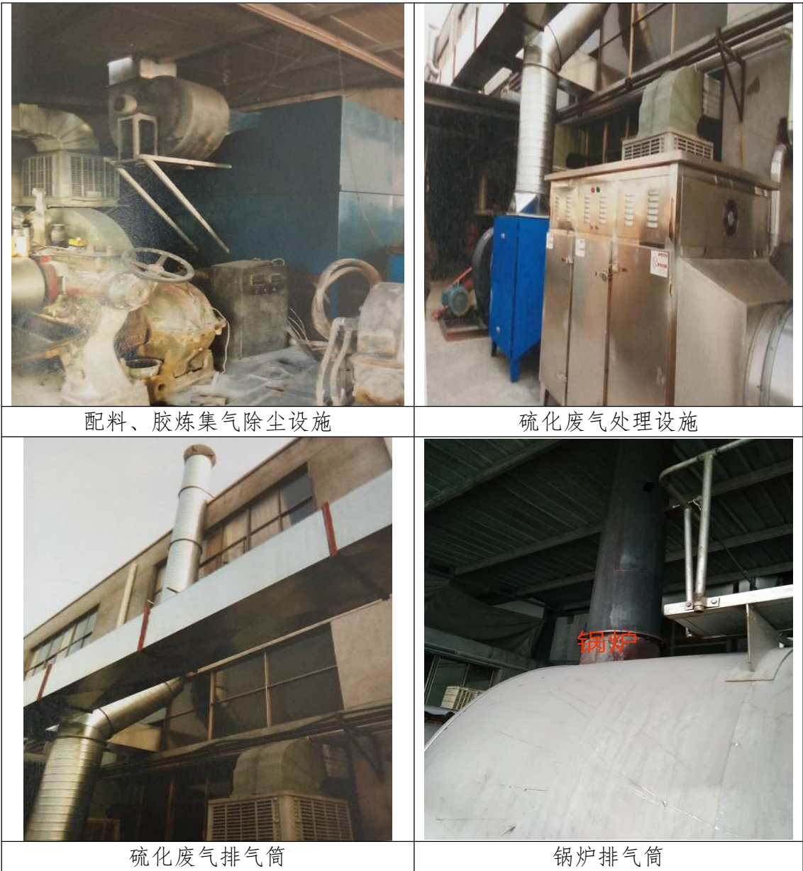
图 4-3 企业废气治理现场相关照片
