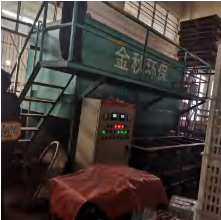
废水处理设备
