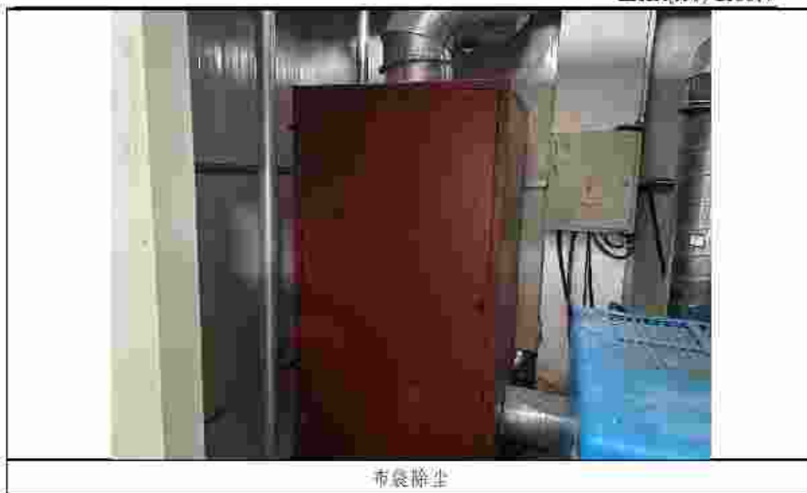
图 4-3 企业废气治理现场相关照片
