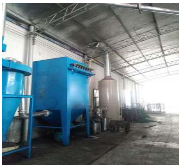
热风炉废气处理设备
