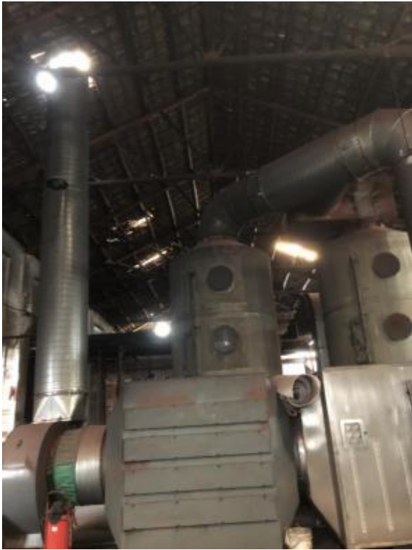
喷漆废气处理设备
