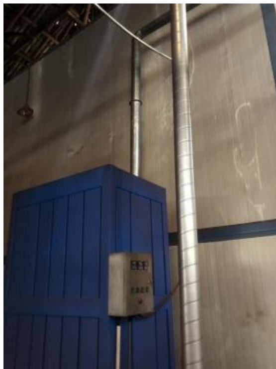
喷漆废气处理设备
