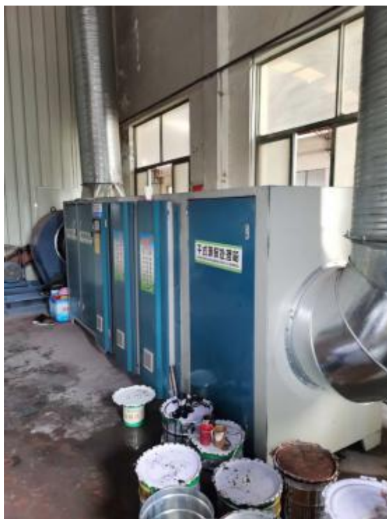
喷漆废气处理设备
