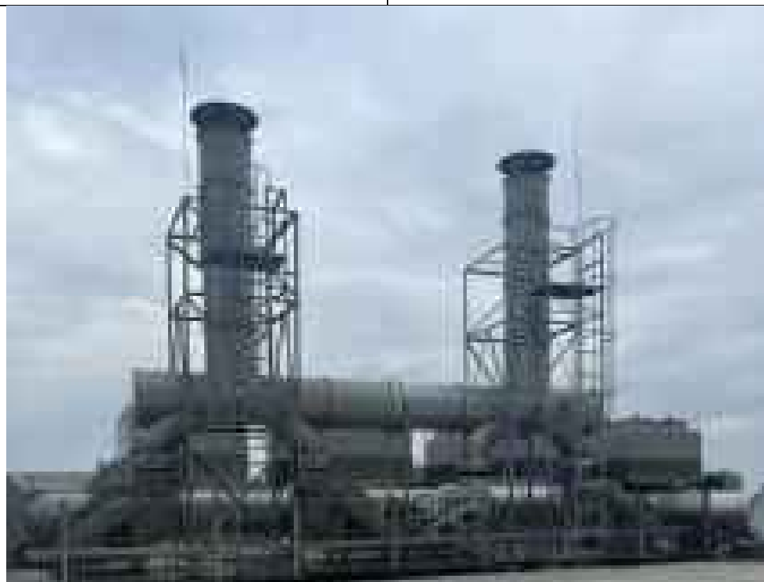
注液、化成废气处理设施
