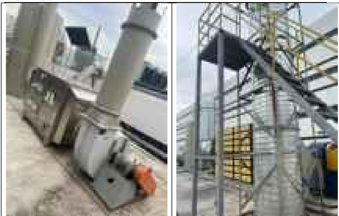
污水站废气处理设施
