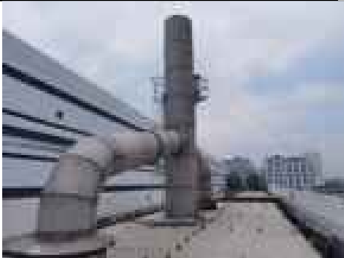
1#天然气废气排放口
