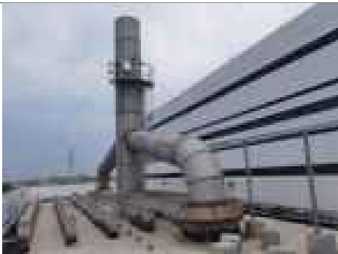
2#天然气废气排放口
