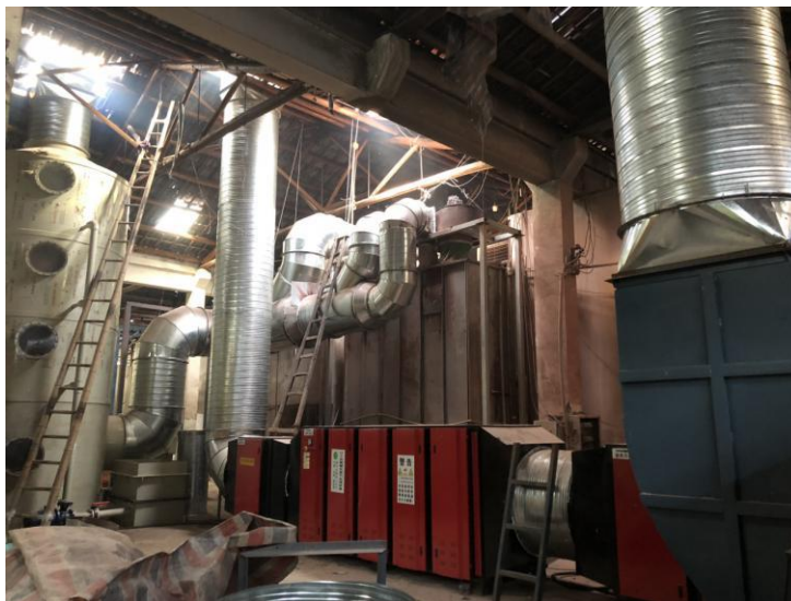
废气处理设备
