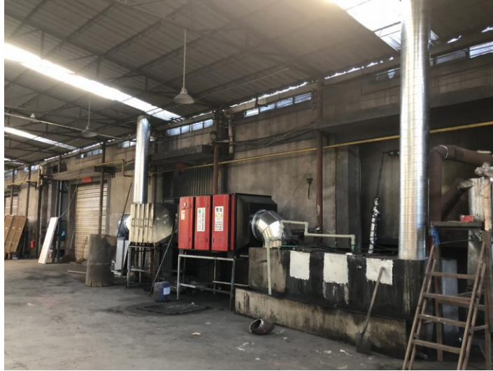
废气处理设备
