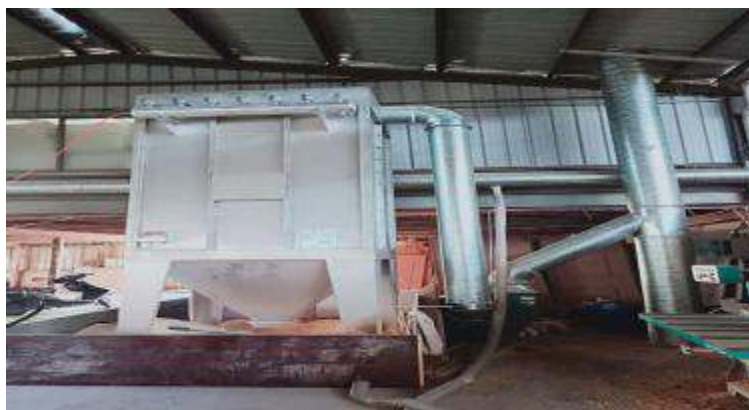
废气处理设施
