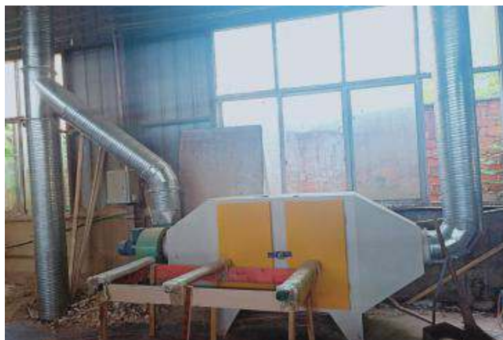
废气处理设施
