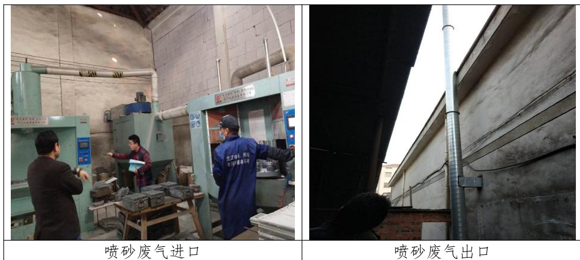
图 4-4 企业废气治理现场相关照片
