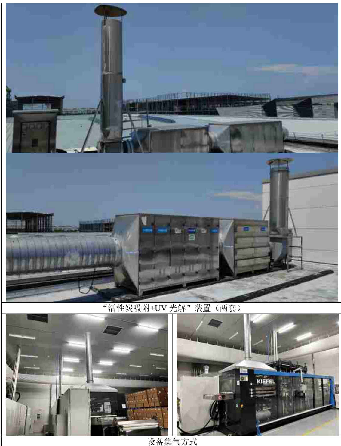
图 4-3 废气处理设施及排放口图
