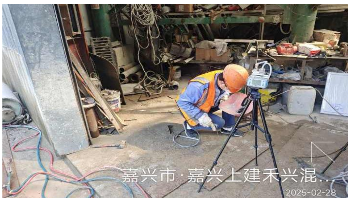
搅拌楼机修岗位
