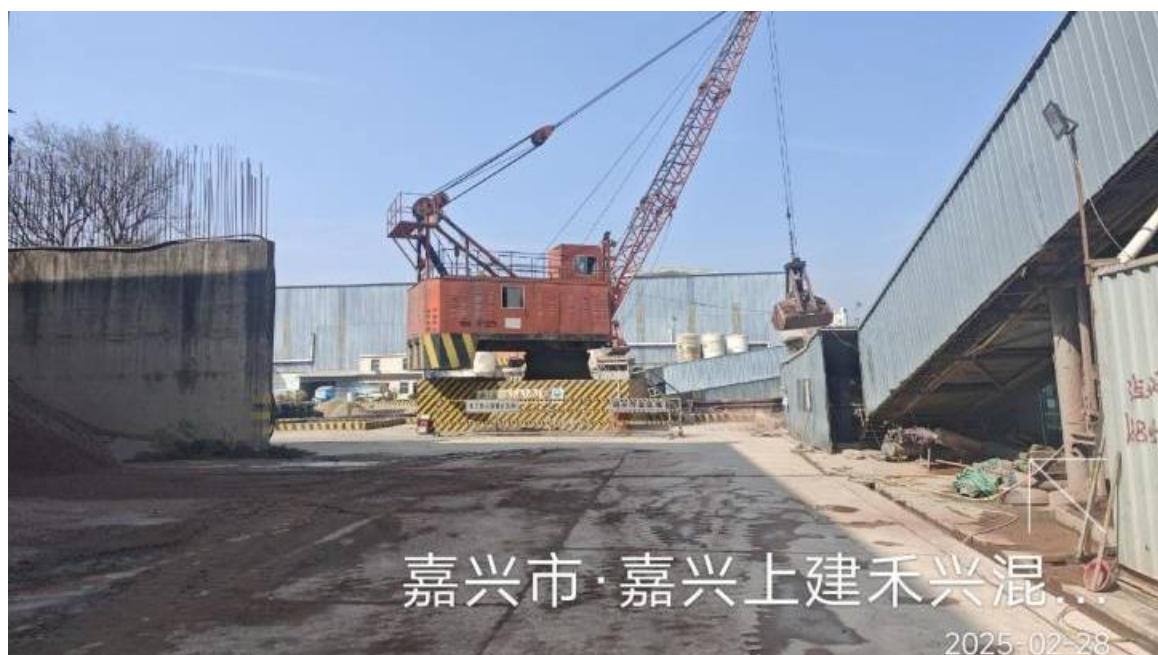
码头吊机岗位
