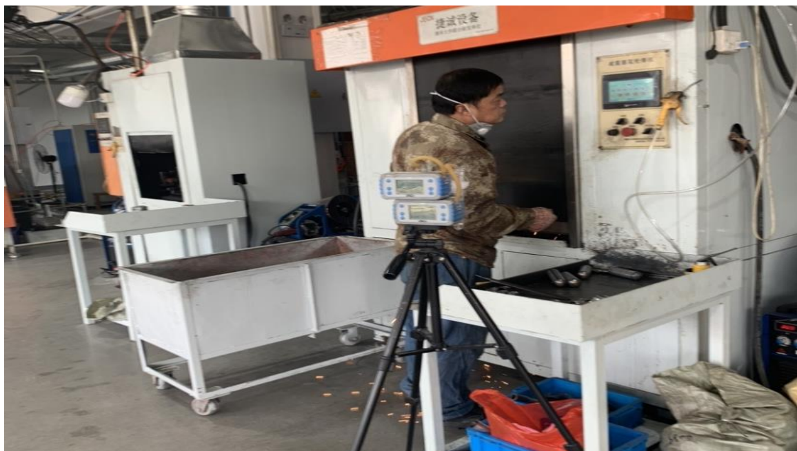
生产车间 3F 缝焊岗位
