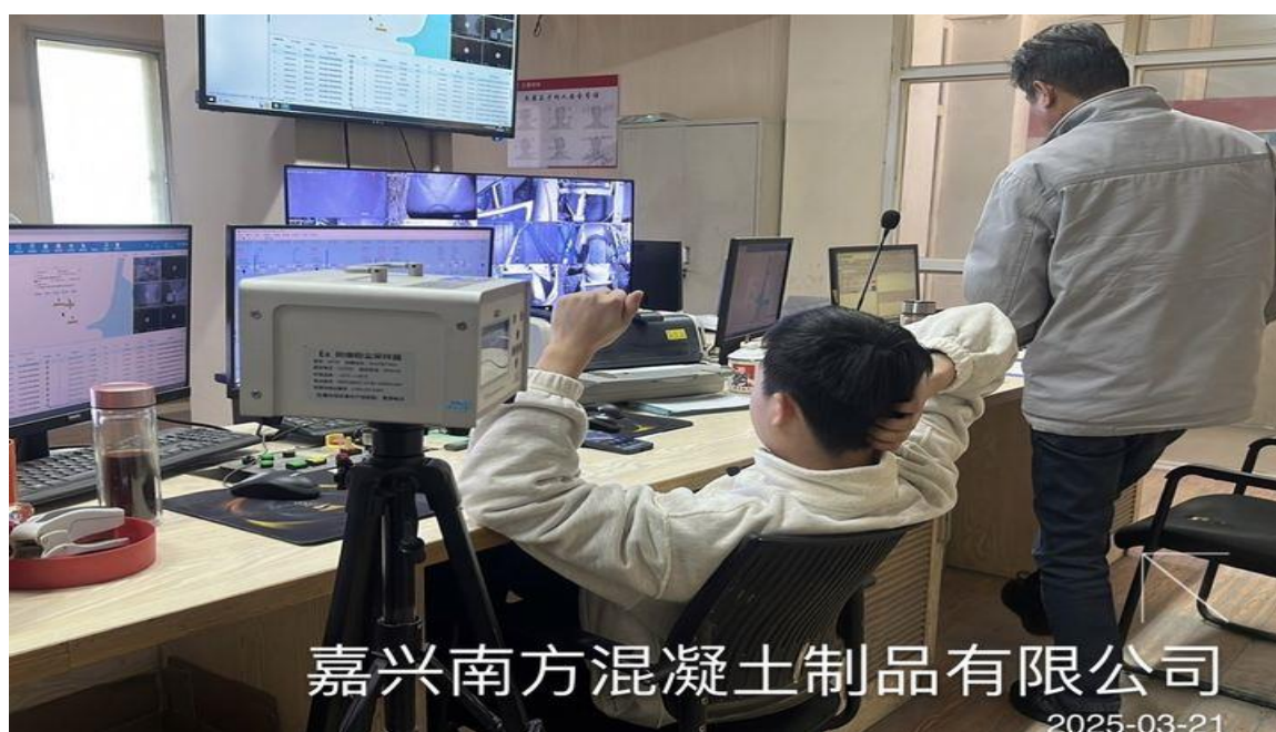
搅拌楼控制室
