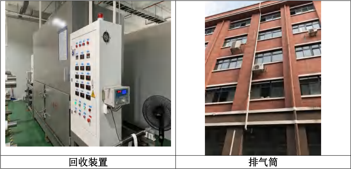
图 4-3 废气处理设施及排放口图
