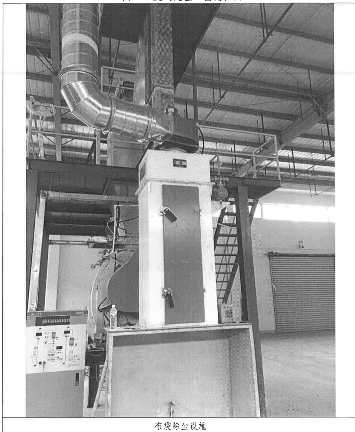
图 4-3 废气处理设施图
