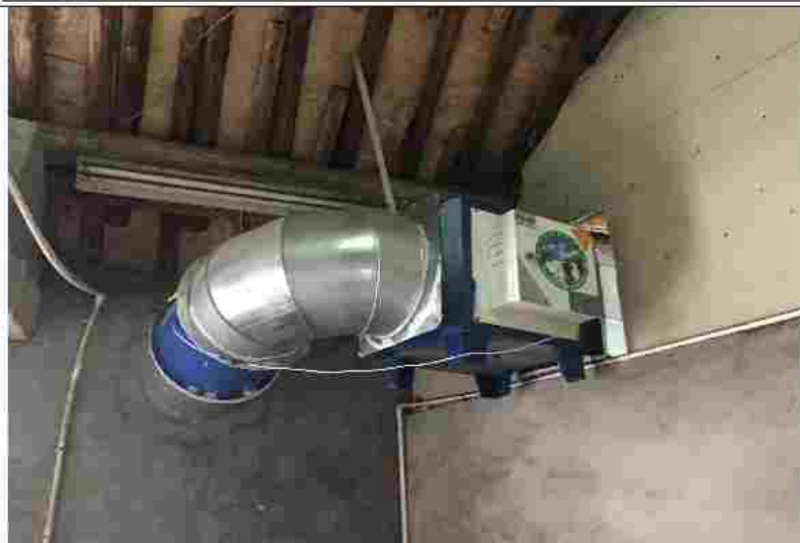
油烟净化处理装置
