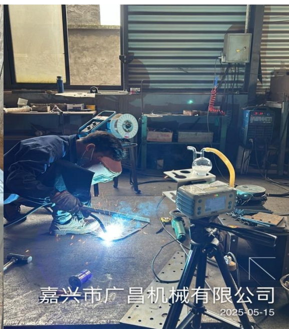
生产车间 2 焊接岗位
