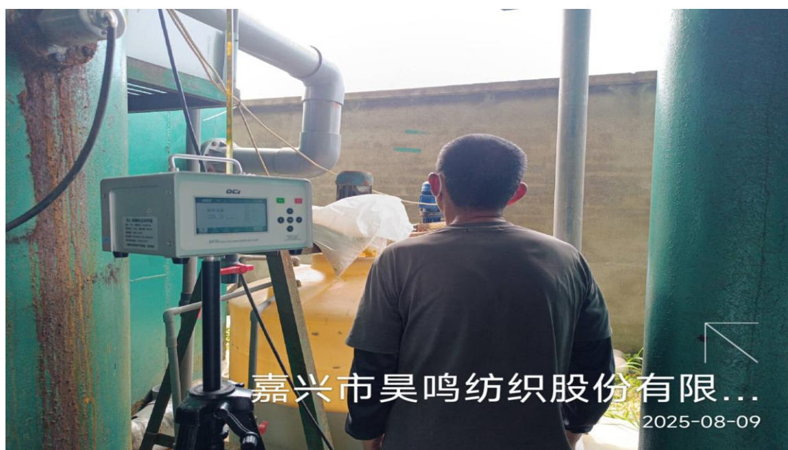
污水站污水处理岗位
