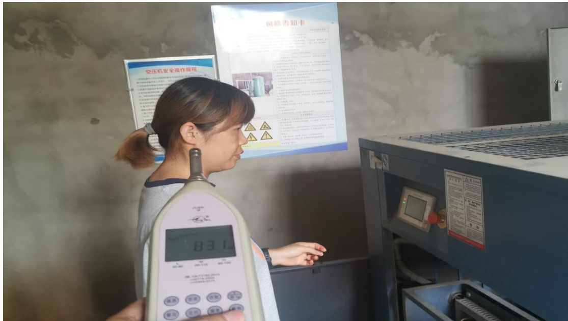
空压机房巡检岗位
