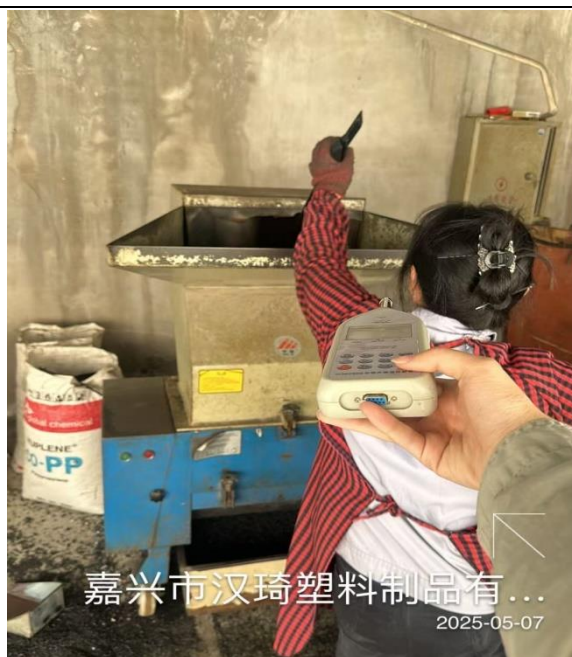
一楼生产车间破碎岗位
