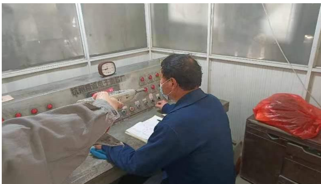
生产车间控制室岗位
