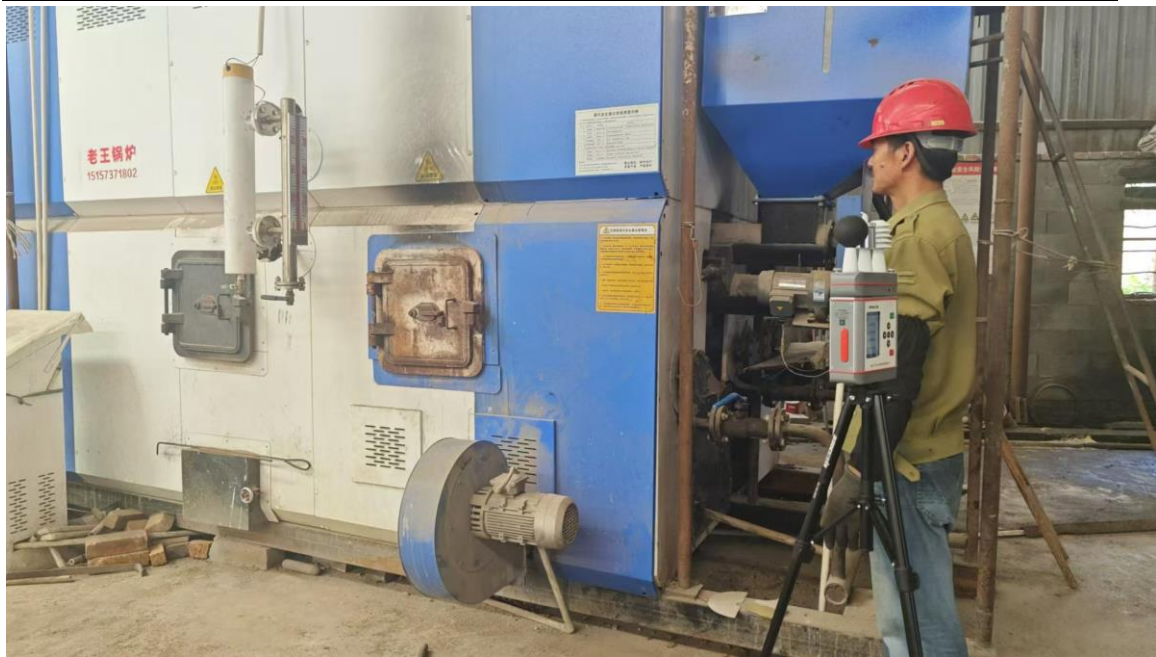
生产车间蒸汽发生器岗位
