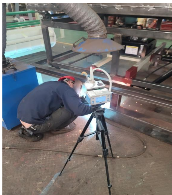
生产车间 1F 手工焊岗位
