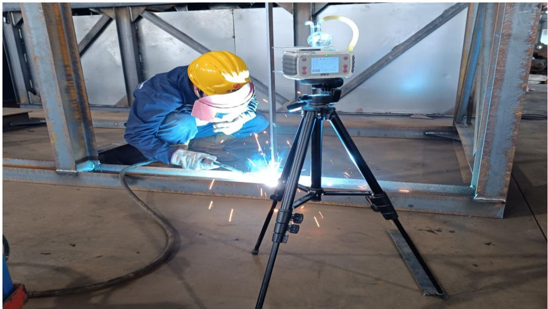
生产车间焊接岗位
