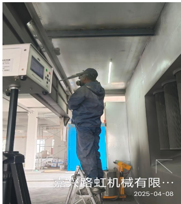
新车间 4 楼喷塑岗位
