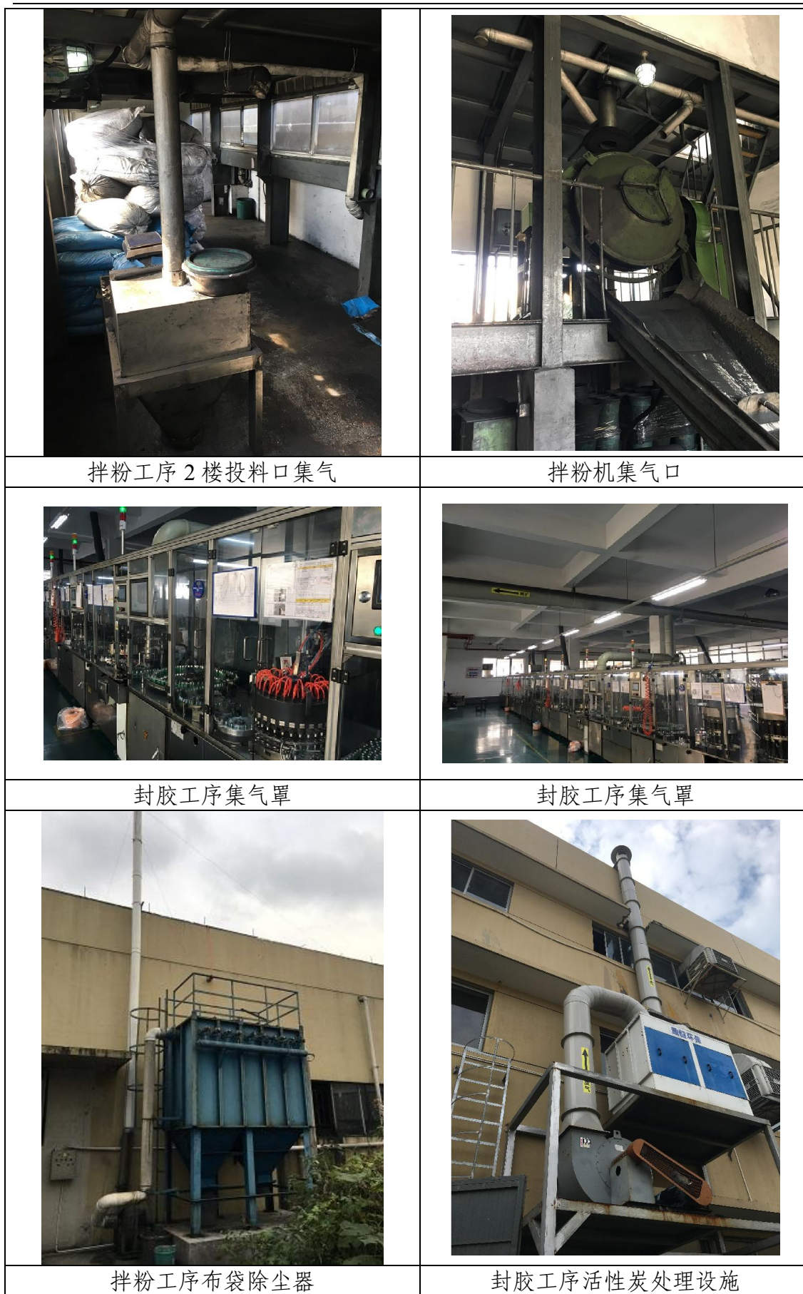
图 4-4 企业废气治理现场相关照片
