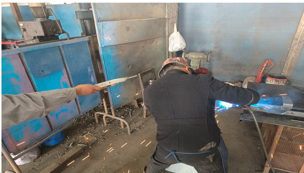
生产车间焊接岗位
