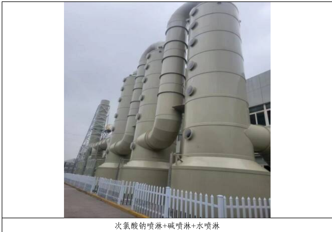
图 4-4 废气处理设施图片
