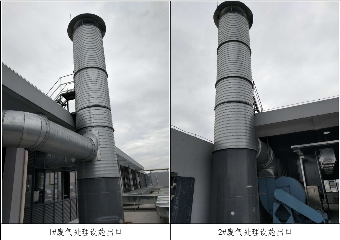
图 4-3 企业废气治理现场相关照片
