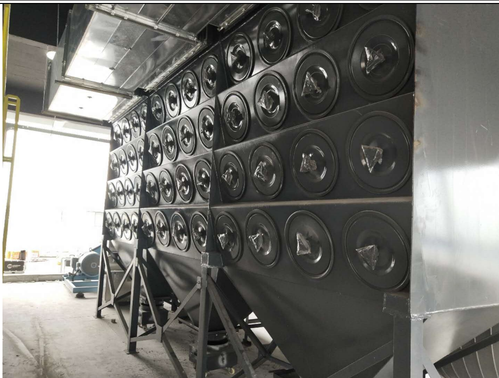
A 栋滤筒除尘器
