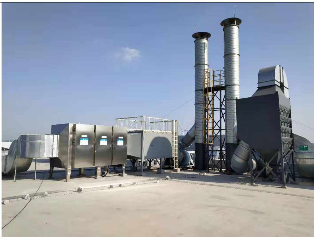
左侧为 B 栋 UV 光解+活性炭吸附装置；右侧为 B 栋滤筒除尘器
