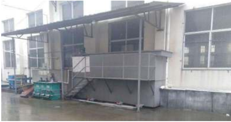
清洗废水处理站
