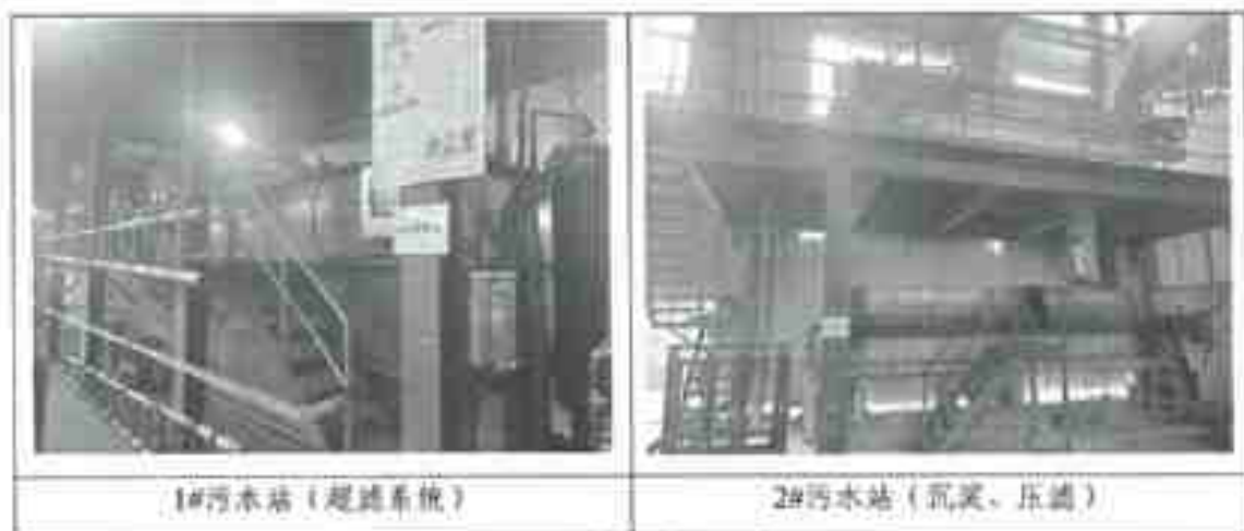
图 4-2 废水处理设施
