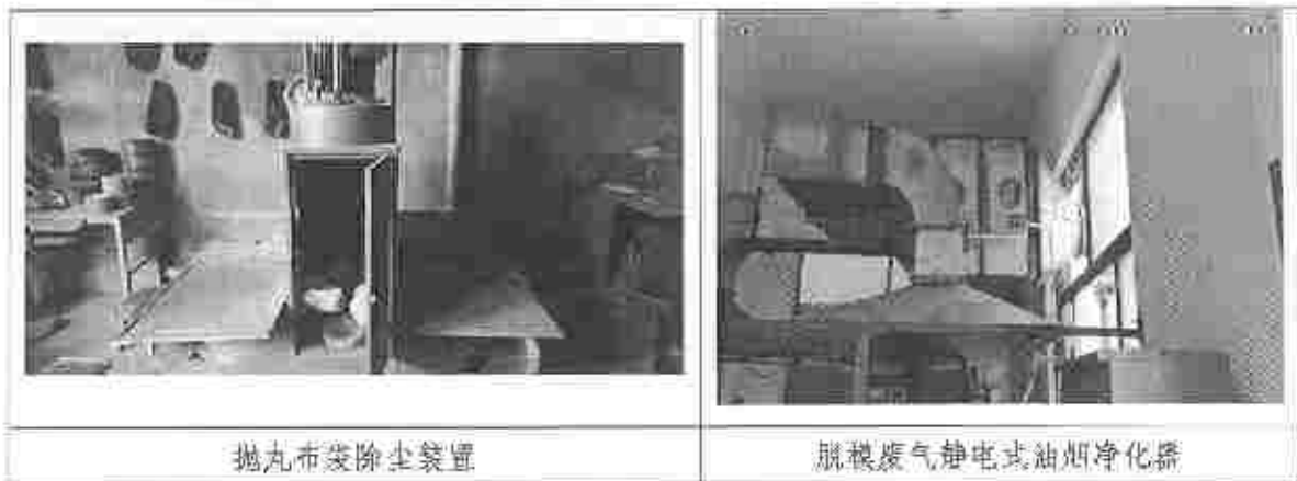
图 4-4 企业废气治理现场相关照片
