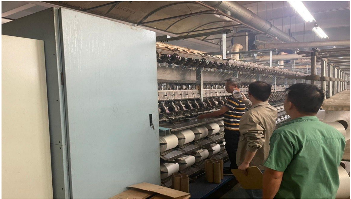
2 车间空变机岗位
