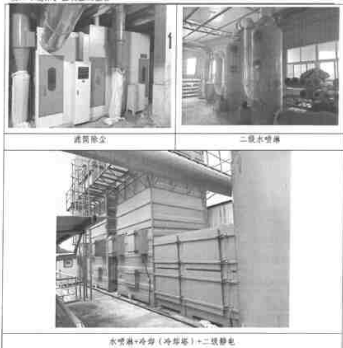
图 4-4 废气处理设施
