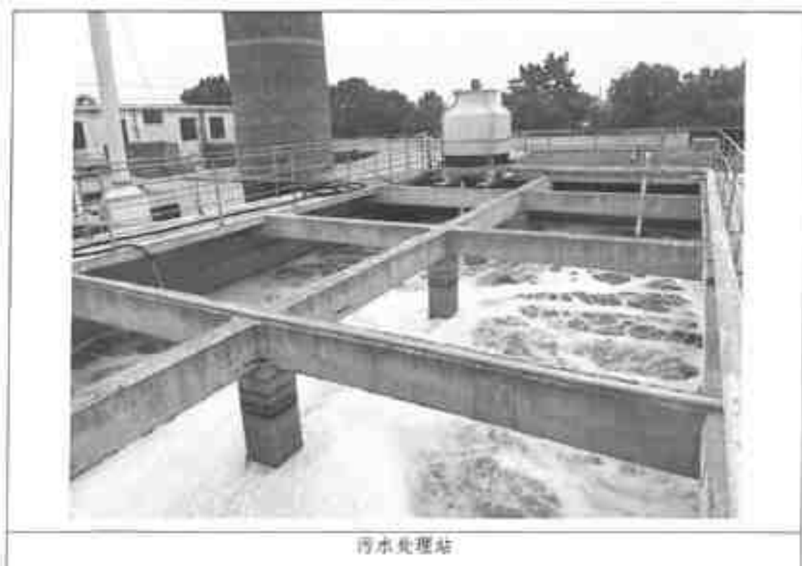
图 4-2 废水处理设施
