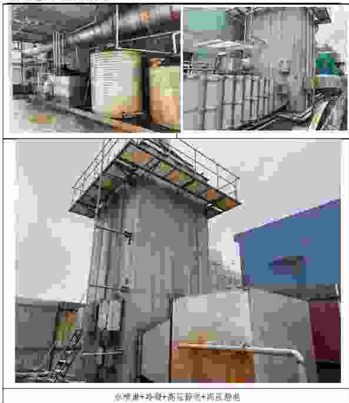
图 4-4 废气处理设施
