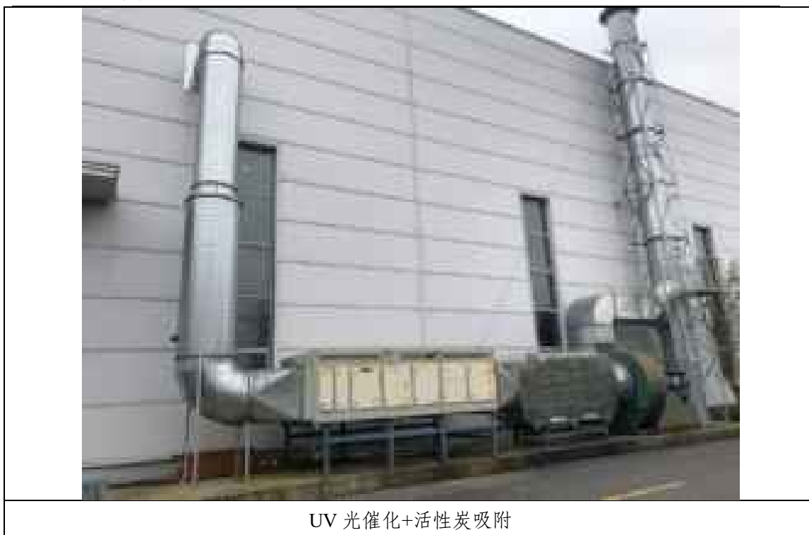
图 4-3 废气处理设施图片
