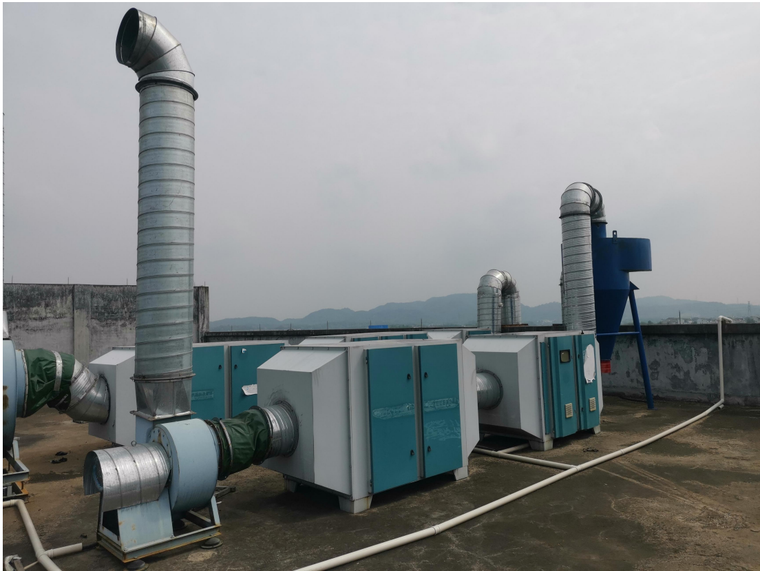
图 4-2 有机废气处理设备
