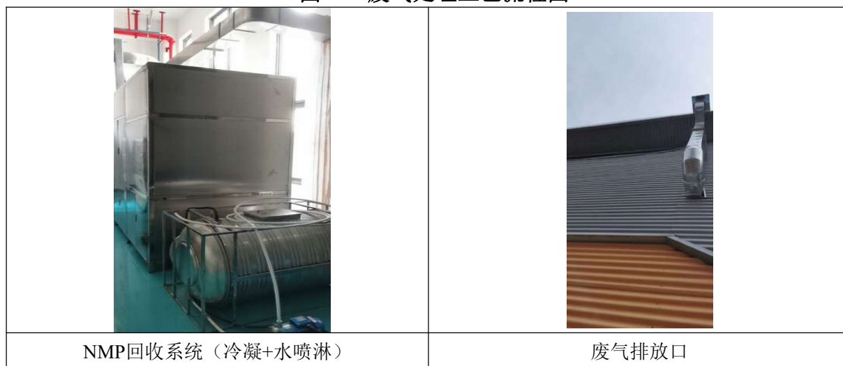
图 4-3 废气处理设施及排放口图
