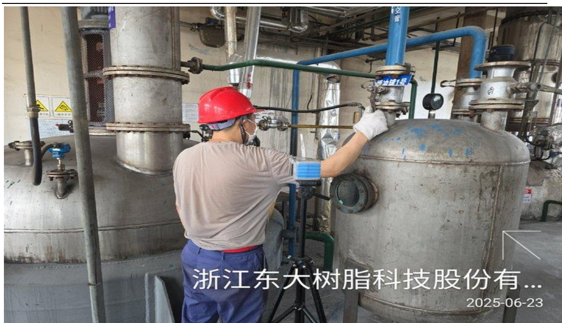
生产车间稀释釜巡检岗位
