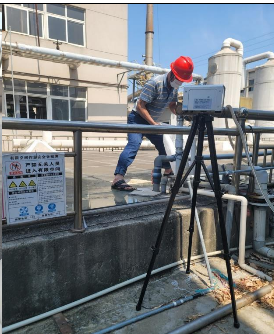
污水处理站投料岗位
