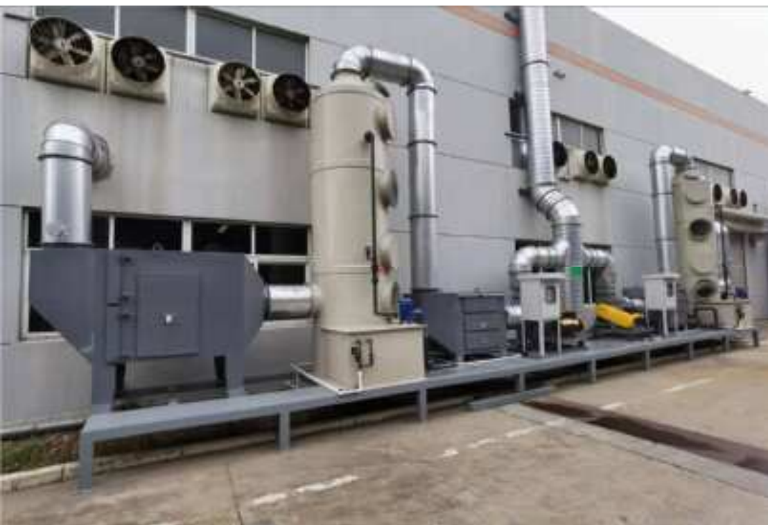
低温烧结废气处理设施（左侧）和 PTFE 烘干废气处理设施（右侧）
