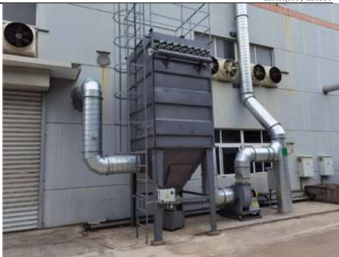
高温烧结废气处理设施
