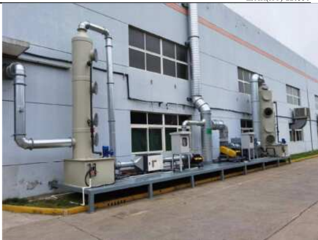
热处理（淬火、调制、回火）废气处理设施（左侧）和水性清洗剂清洗废气处理设施（右侧）
