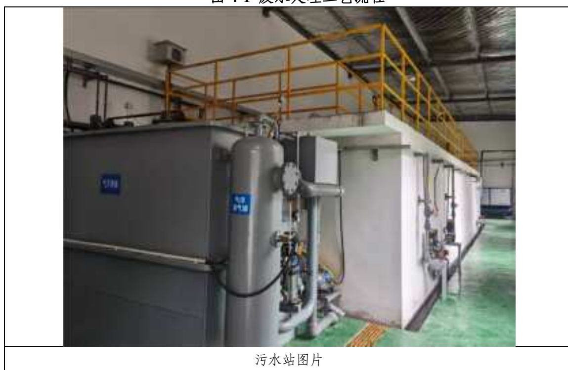
图 4-2 废水处理设施图片
