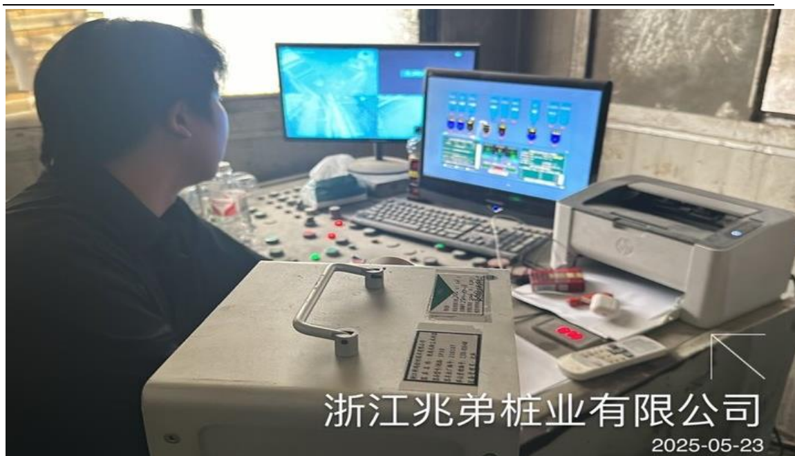
生产车间控制室岗位
