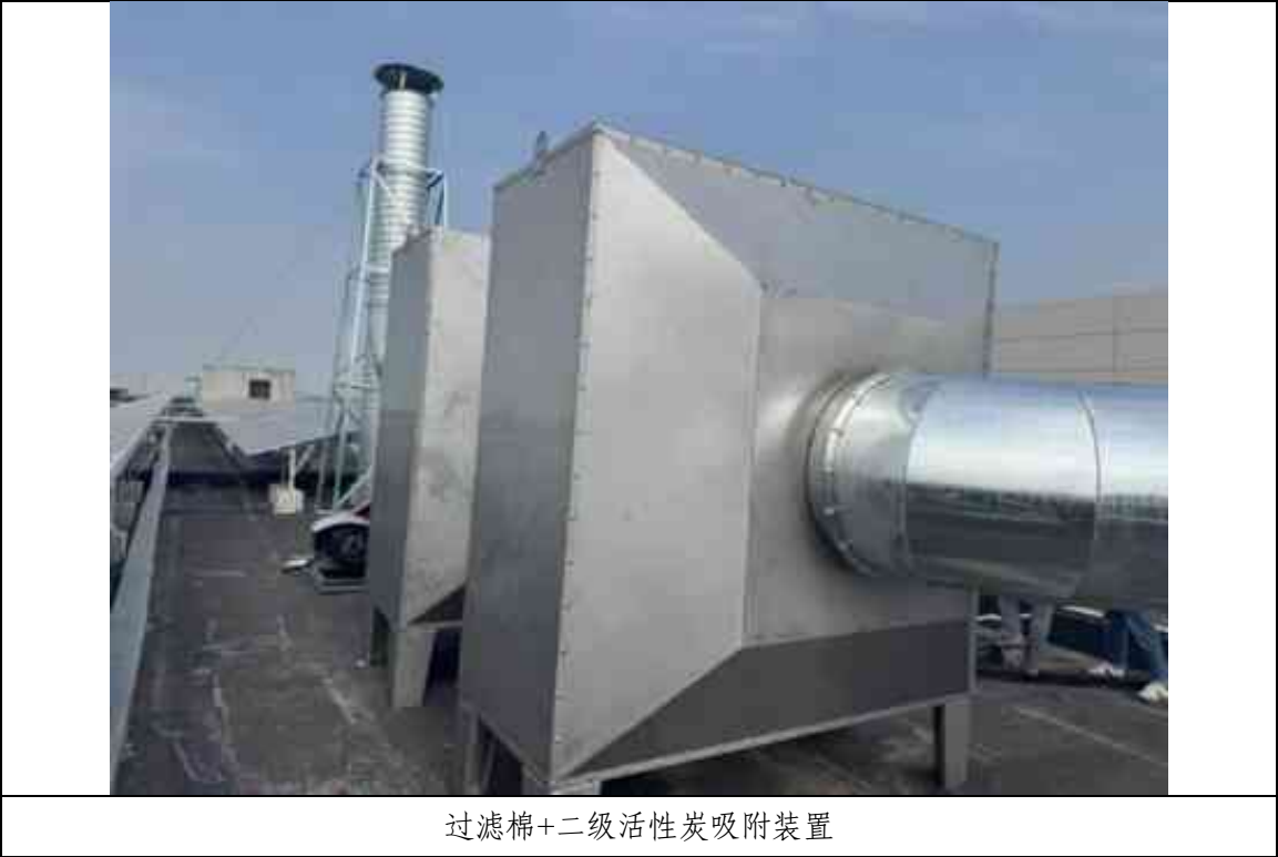
图 4-3 废气处理设施图片
