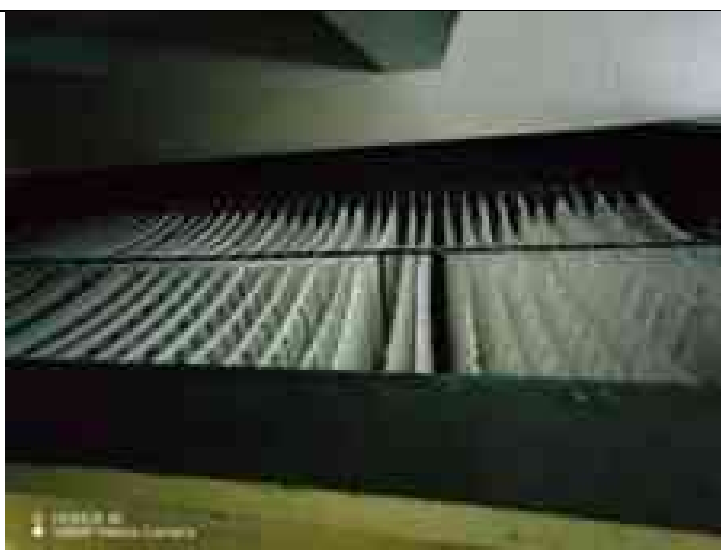
综合废水：厌氧池
