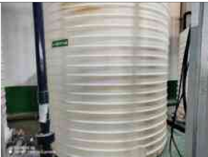
综合废水：中间水池 3
