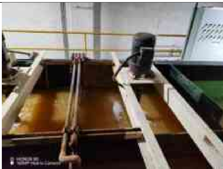
含氰含银废水、含银废水：混凝池 2
