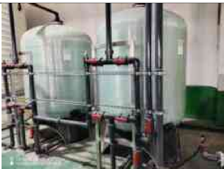
综合废水：砂滤器
