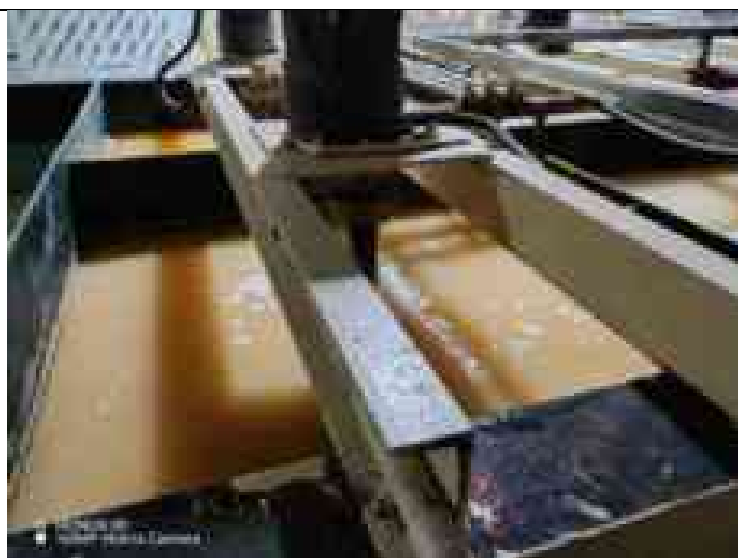
含氟含银废水、含银废水：混凝池
