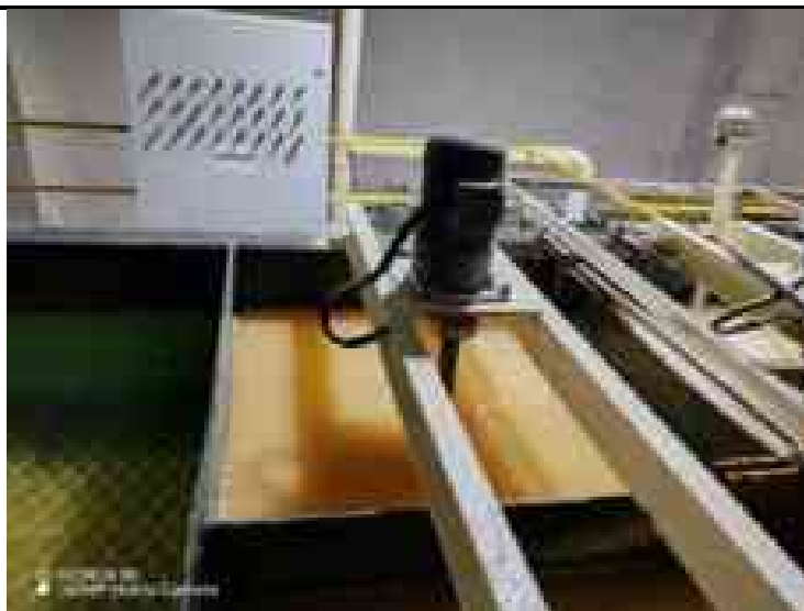
含氰含银废水、含银废水：絮凝池
