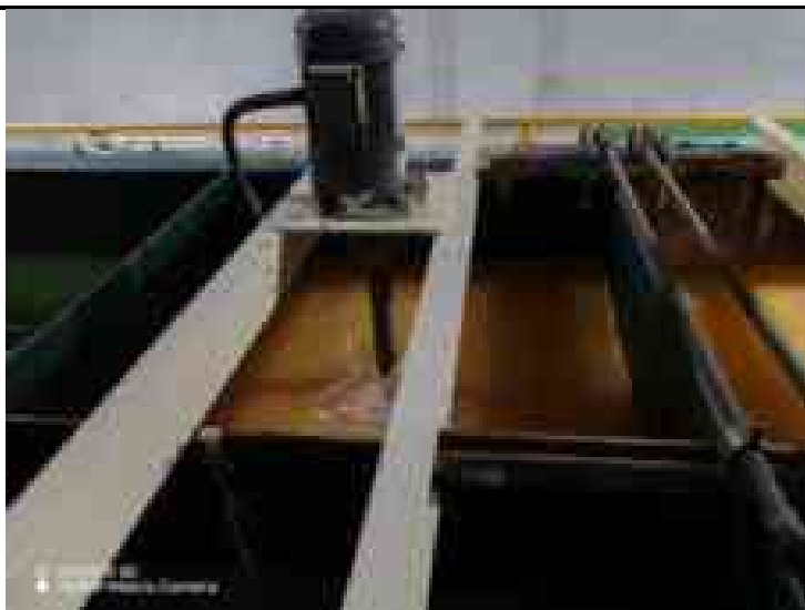
含镍废水：絮凝池 2
