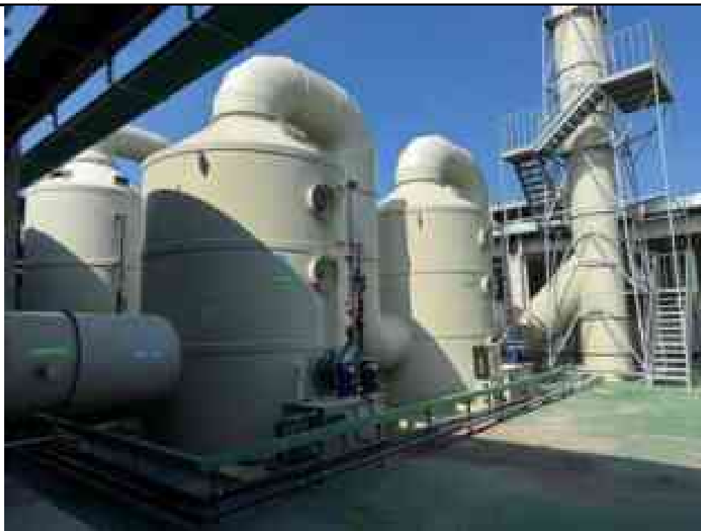
2#酸性废气处理设施
