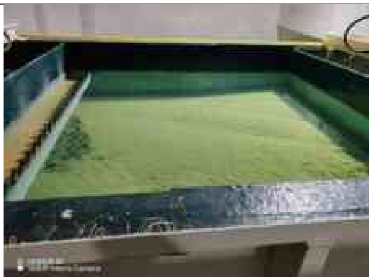
含镍废水：沉淀池
