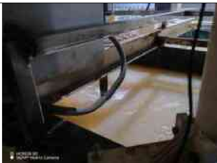
含氟含银废水、含银废水：二级破氟反应池
