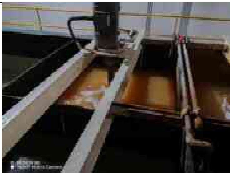
含氰含银废水、含银废水：絮凝池 2
