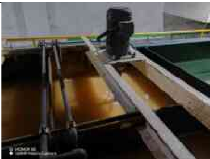
含镍废水：混凝池 2
