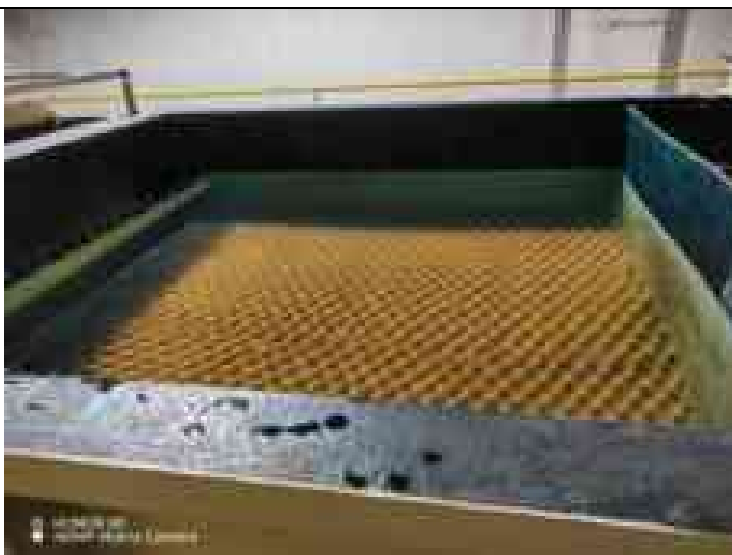
含氰含银废水、含银废水：沉淀池
