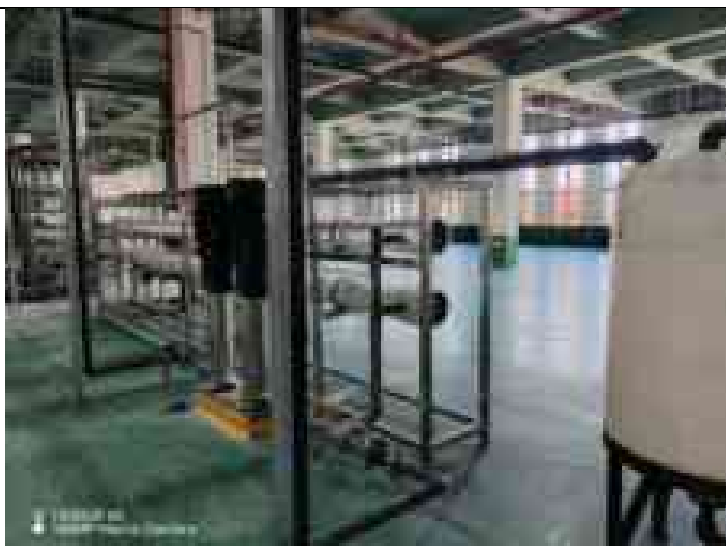
综合废水：超滤系统
