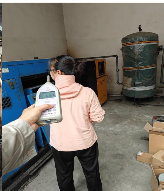
空压机房巡检岗位
