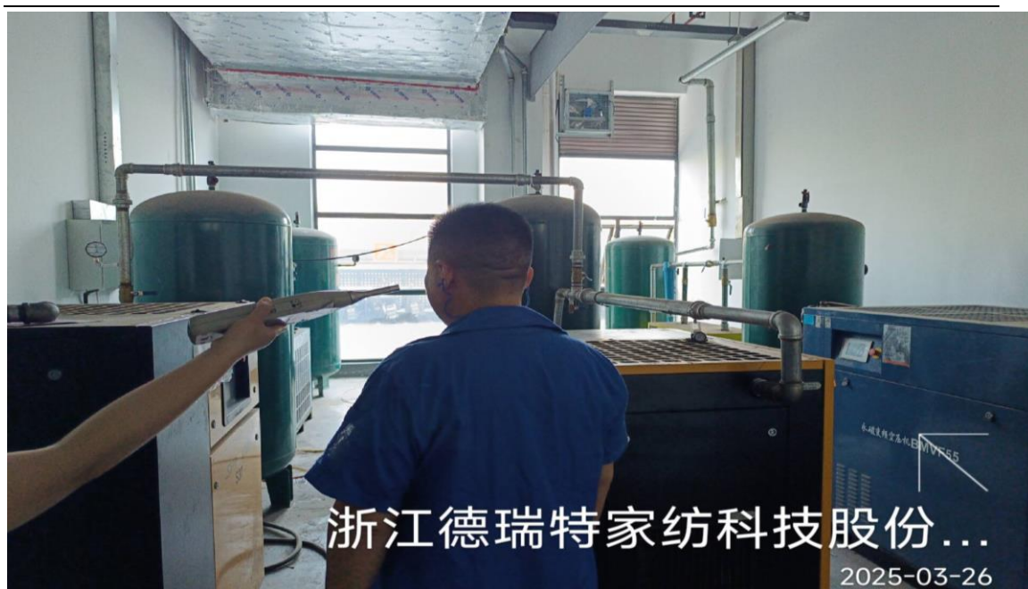
空压机房巡检岗位
