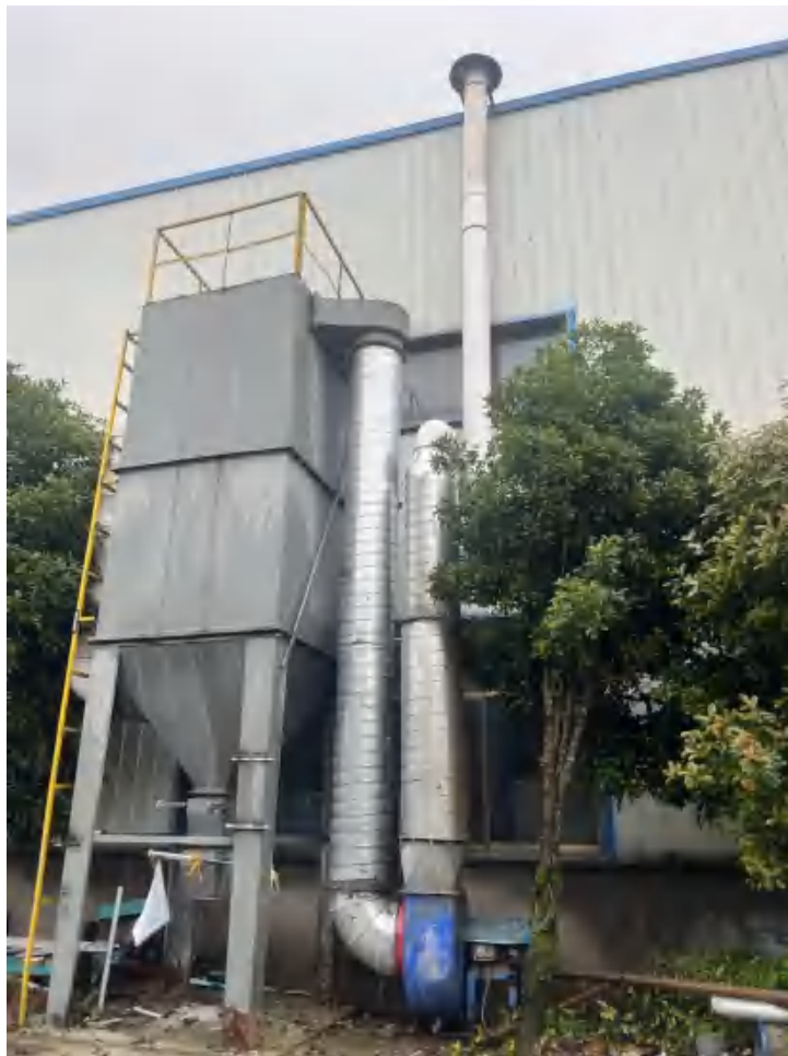
搅拌、废气粉尘除尘器
